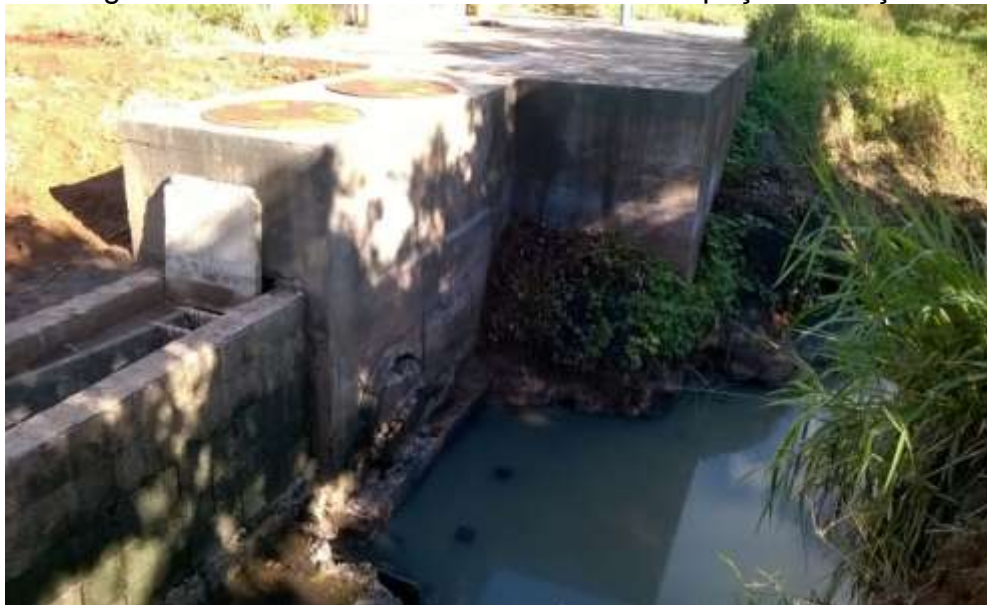
Figura 5. Vista do canal da calha Parshall e poço de sucção
