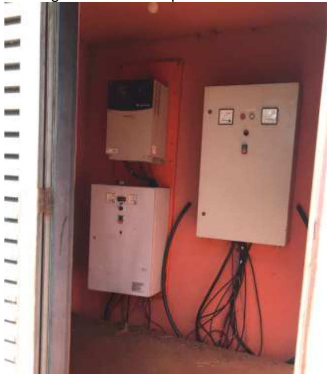
Figura 7. Vista do quadro de comando.
