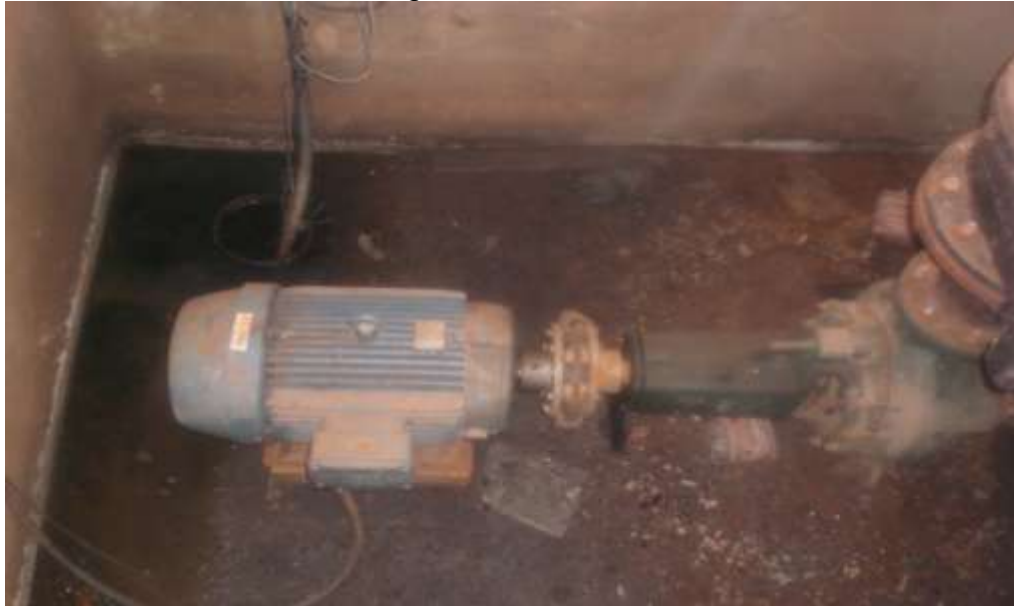
Figura 6. Vista interna do poço seco com destaque para um dos conjuntos motobomba centrífugos de eixo horizontal.
