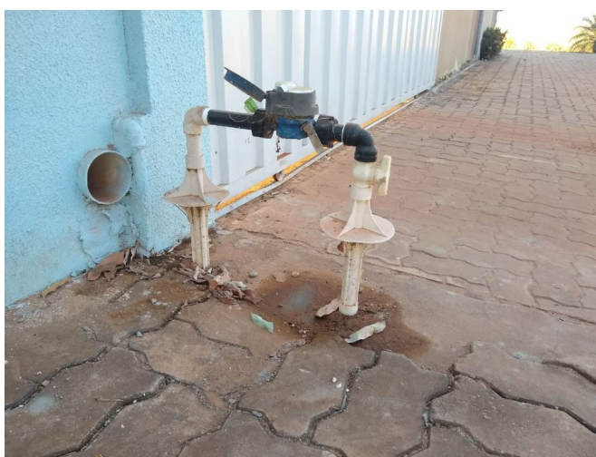
Situações tipicamente encontradas de cavalete para substituir
