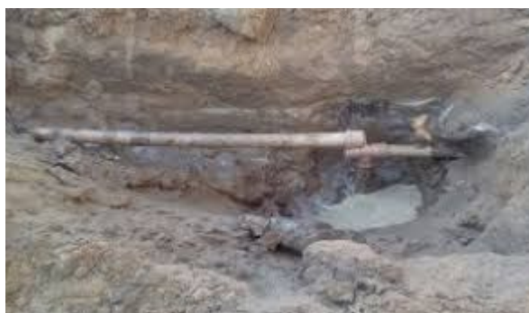
Situação tipicamente encontrada de ligação irregular ou fraudada
