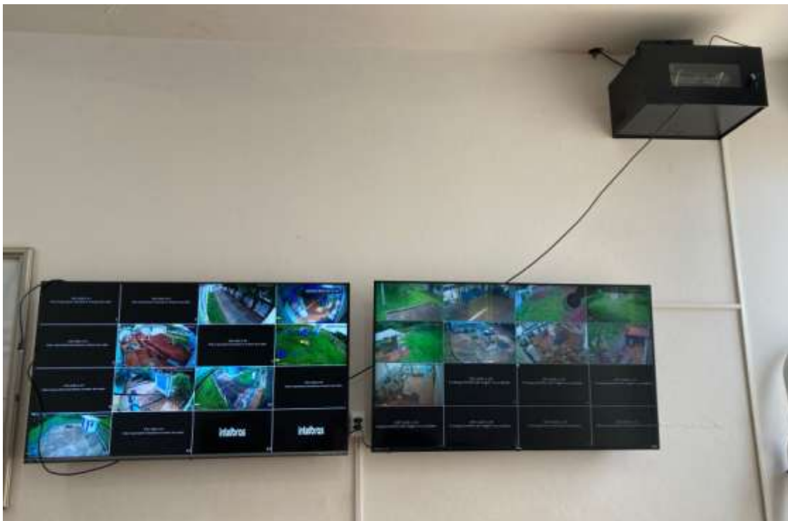
Imagem 01: Vista das TVs e equipamentos do sistema de monitoramento.
